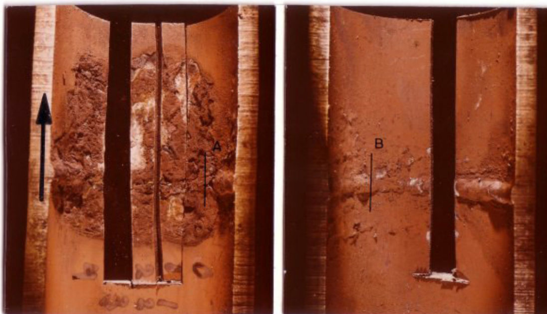
Figure 17: Sterk gecorrodeerde autogene las in een verdamperspijp. De pijl geeft de stroomrichting in de pijp aan.
