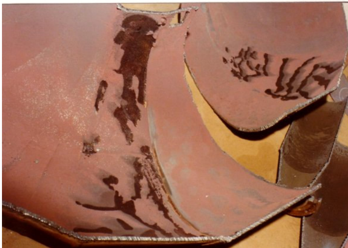
Figuur 22 De natte stoomleiding achter de waterafscheider, waarin de plaat met de hoge G_{KEMA} waarde (95) was aangetast. De naburige niet aangetaste platen hebben een waarde van 75. (foto KEMA).
